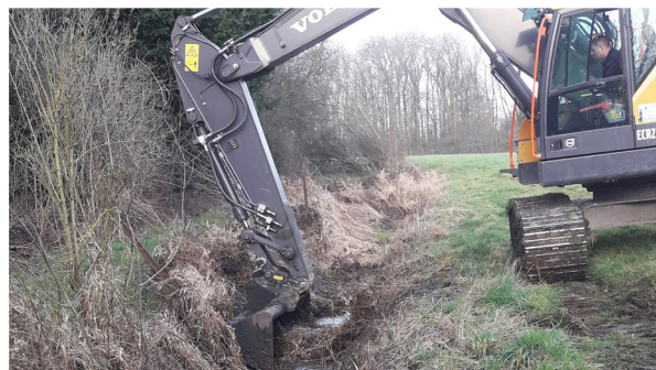
3,8 km de fossés ont été curés afin de favoriser les écoulements des eaux pluviales. (allée de la nouvelle Drève, rue de la Fraternité, bas de la rue Pasteur et la plaine de Montifaut)
